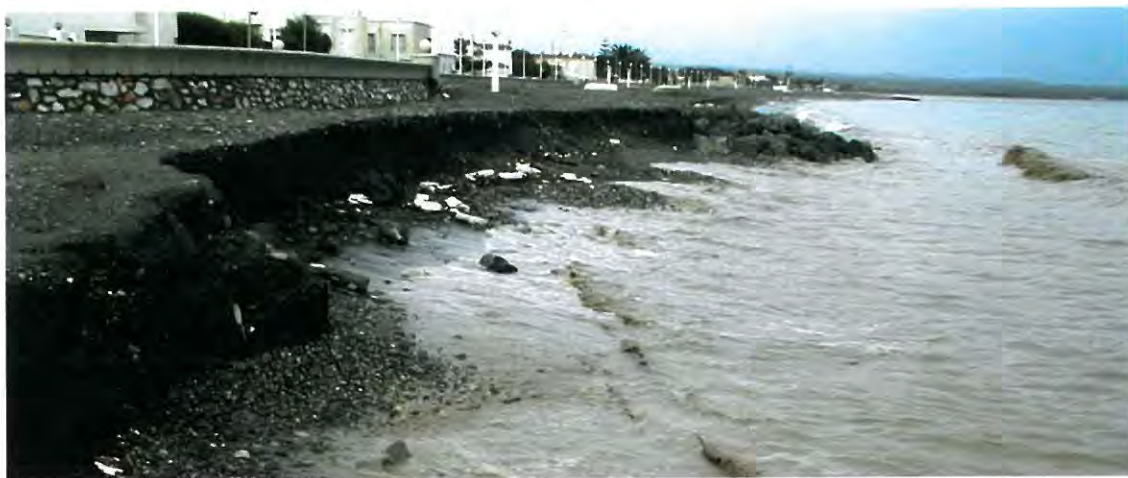
Fotografía 25. Retroceso de la línea de costa.
